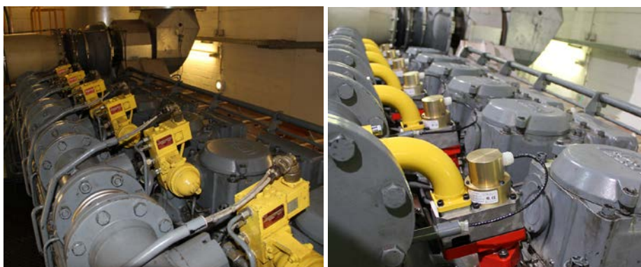
Alt vs. neu: Die hydraulisch betätigten Gasventile (links) wurden durch moderne elektrische Gasventile (rechts) ersetzt.
