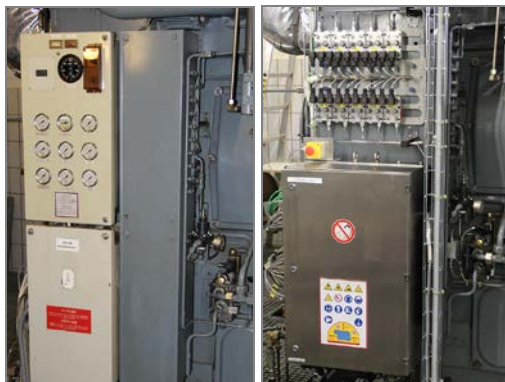
Alt vs. neu: Der alte Schaltschrank (links) wurde durch ein modernes Steuerungssystem (rechts) ersetzt.
