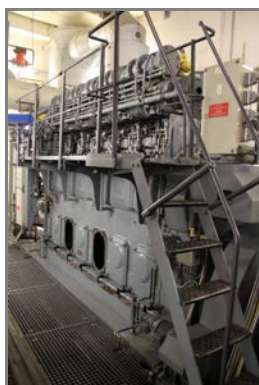
Der Großmotor MAN 6L 32/40DF vor Ort im BHKW der Deutschen Bundesbank in Frankfurt
